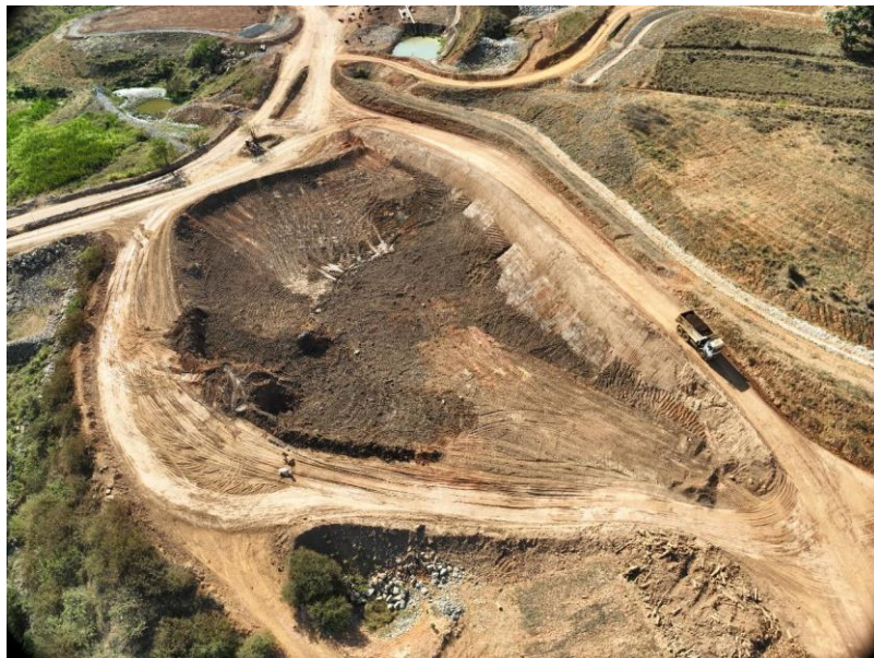
Figura 1 – Em andamento descaracterização das estruturas ASS4
