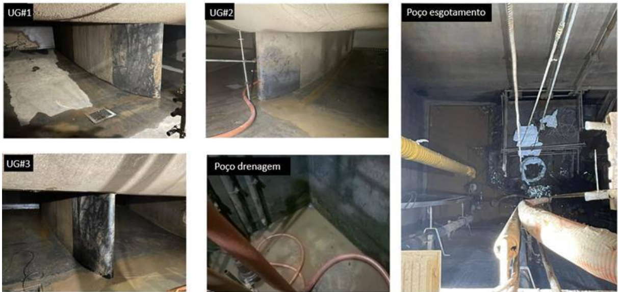
Figura 14 - Conclusão da Limpeza do Circuito Hidráulico da UHE RN (Limpeza túneis Esquerdo e Direito – UG1, UG2 e UG3)
