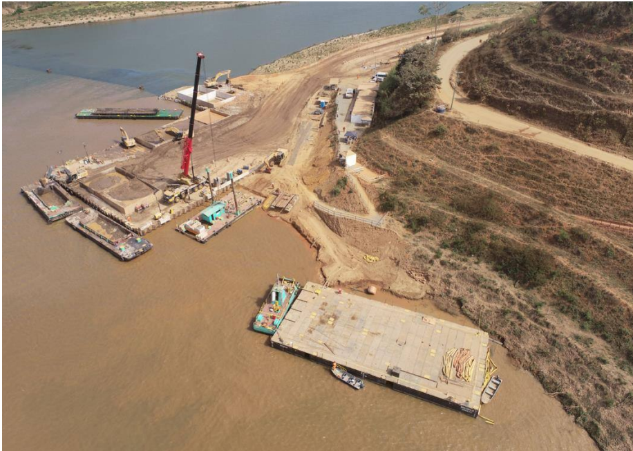
Figura 3 – Ciclo de Atividades de descarga nas baias localizadas no Ponto de Apoio
