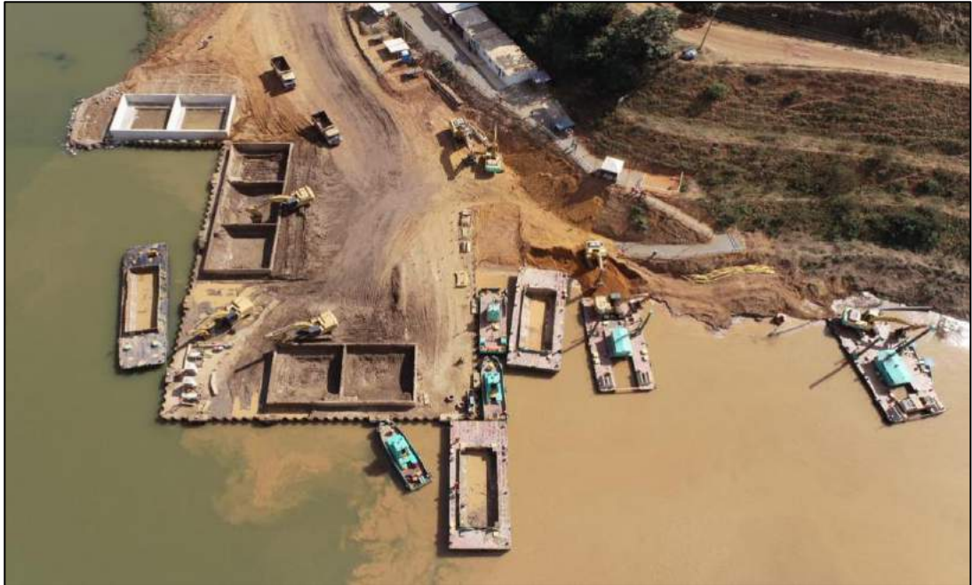
Figura 3 – Ciclo de Atividades de descarga nas baias localizadas no Ponto de Apoio
