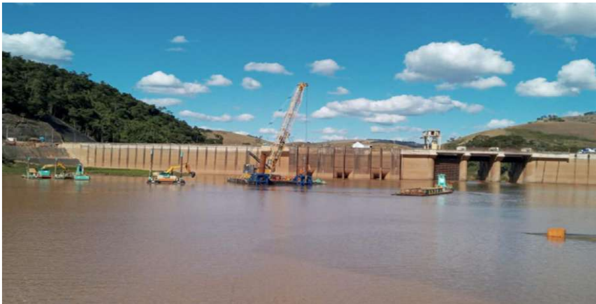
Figura 4 - Remoção de sedimentos dos conjuntos escavadeiras/ balsa e do conjunto guindaste/ balsa
