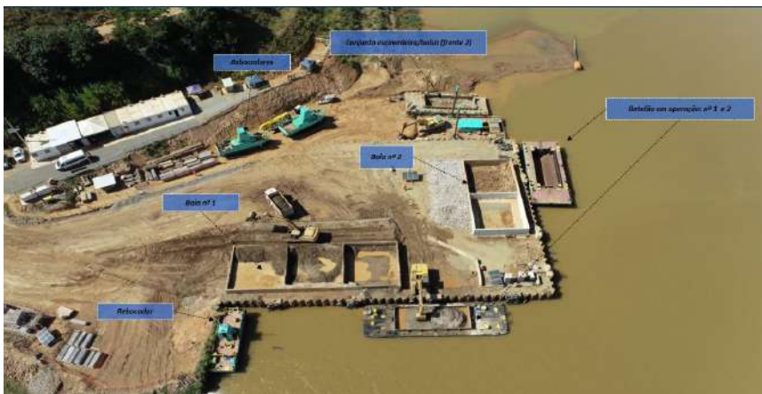
Figura 3 - Descarregamento dos módulos da balsa / Montagem da balsa e lançamento no rio
