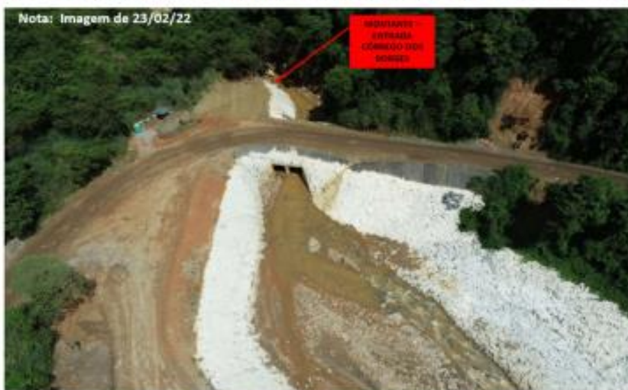
Figura 14 - Montante Setor 4 - Entrada
