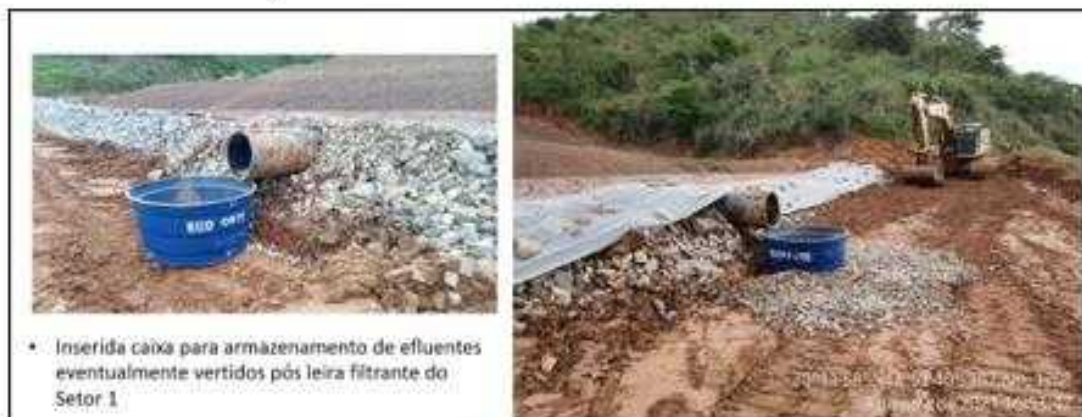
Figura 25 - Dreno do tubo de direcionamento de efluente do setor 1
