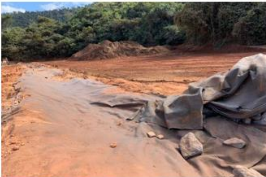
Figura 18 - Melhoria realizada: direcionamento do greide do terreno para canaleta envoltória com manta geotêxtil
