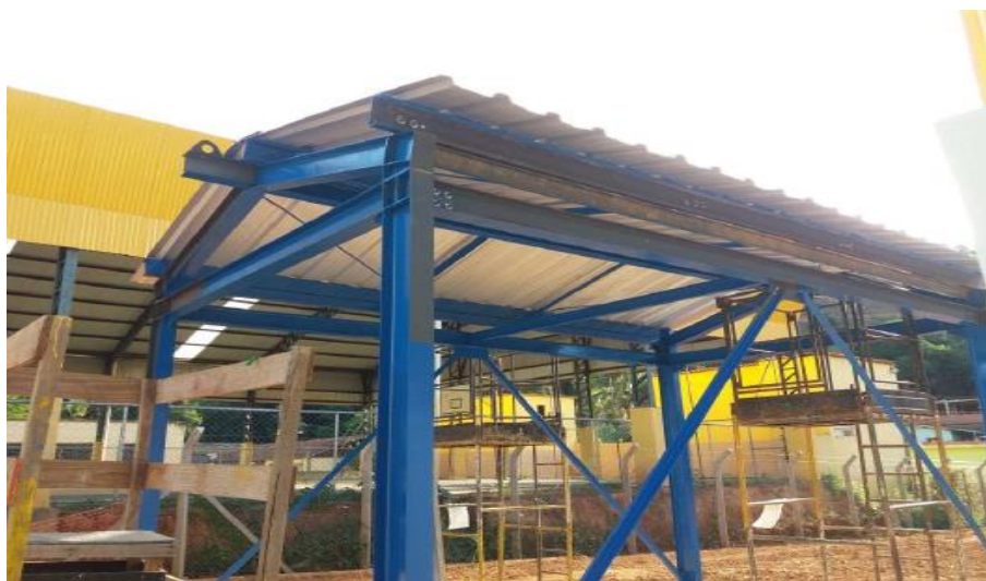
Foto relacionada às: obras da cobertura do Sistema Abrandador do poço de Pedra Corrida, distrito de Periquito/MG – janeiro/2020.
