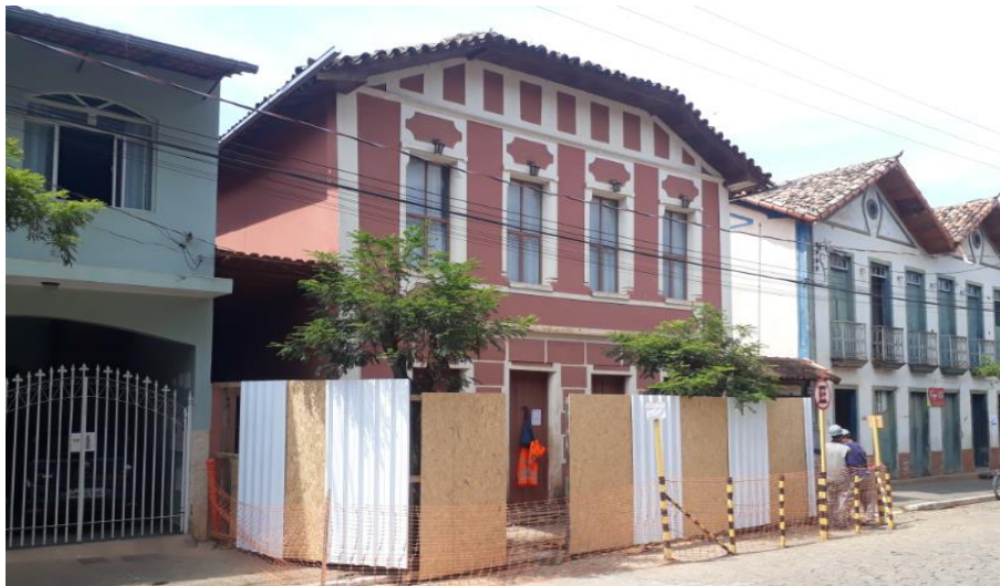
Foto relacionada à: início da obra de restauro em imóvel tombado no município de Barra Longa – janeiro/2020.
