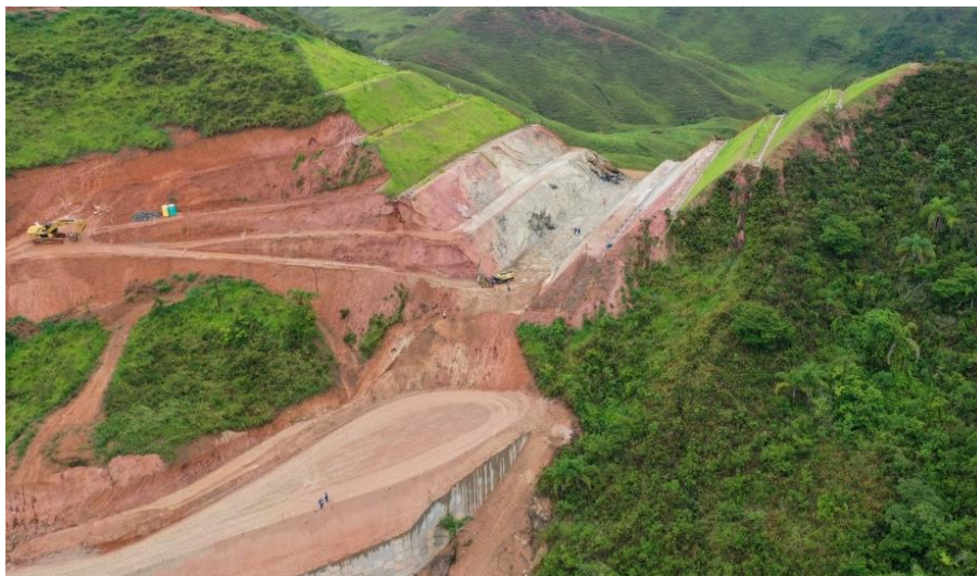
Foto relacionada à: Terra armada no trecho B do acesso principal em Paracatú de Baixo/MG – janeiro/2020.
