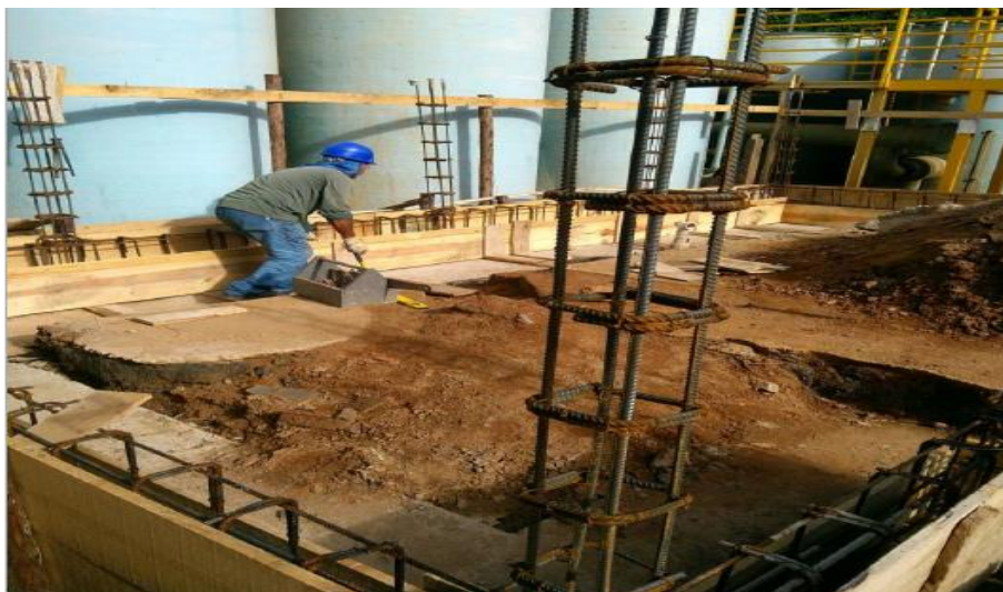
Foto relacionada à: concretagem da base dos tanques de contenção da ETA Vila Isa, em Governador Valadares/MG – janeiro/2020.
