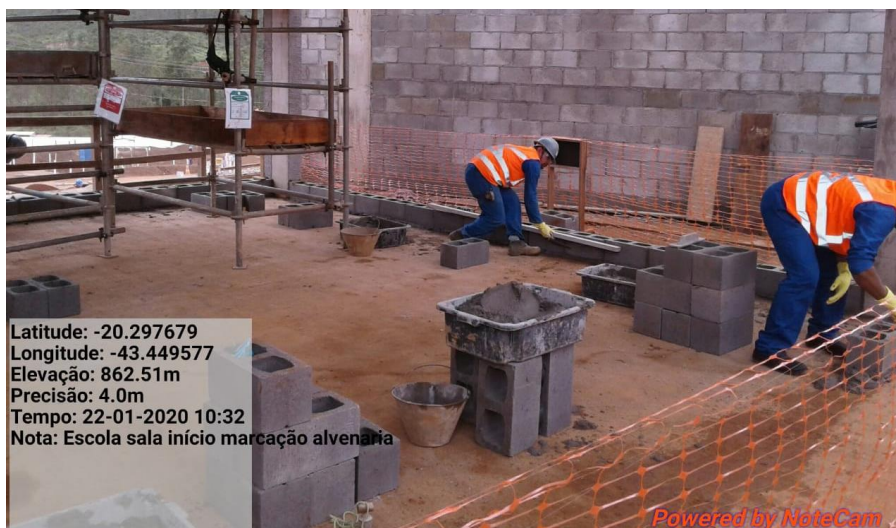
Foto relacionada à: Alvenaria da sala de aula (Escola) de Bento Rodrigues/MG – janeiro/2020.
