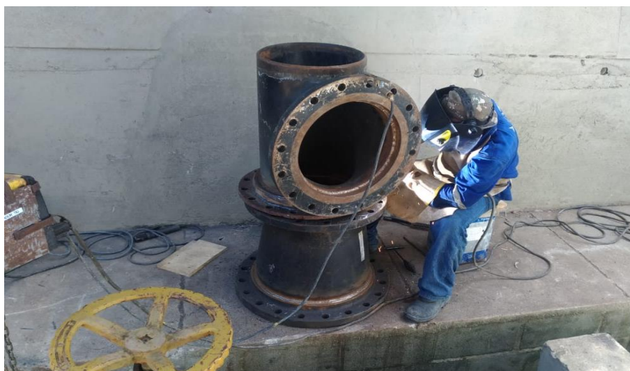
Foto relacionada ao: início das obras de adequação do Barrilete da captação da Lagoa Nova em Linhares/ES – janeiro/2020.
