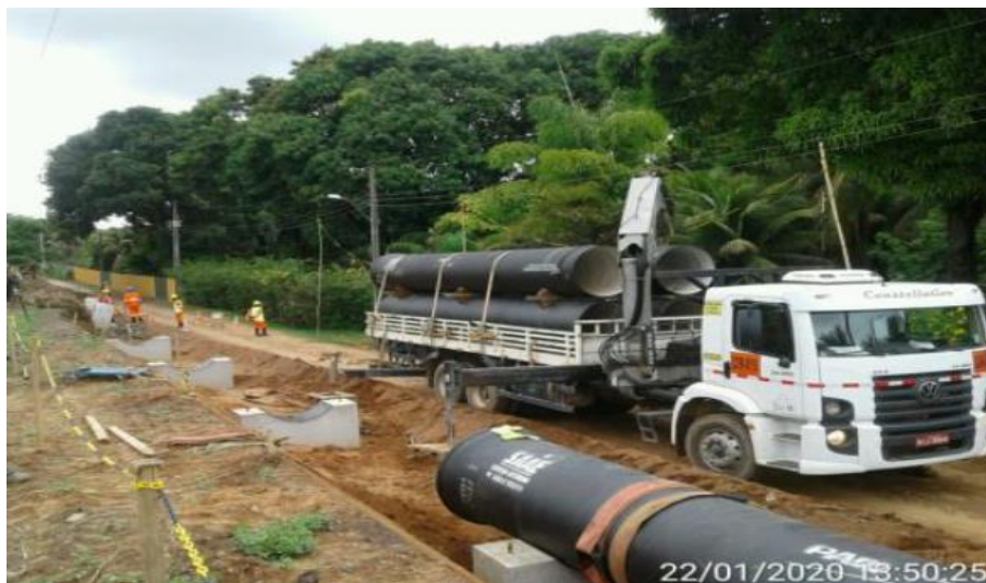
Foto relacionada ao: lançamento da tubulação no Ramal Principal, em Governador Valadares/MG – janeiro/2020.
