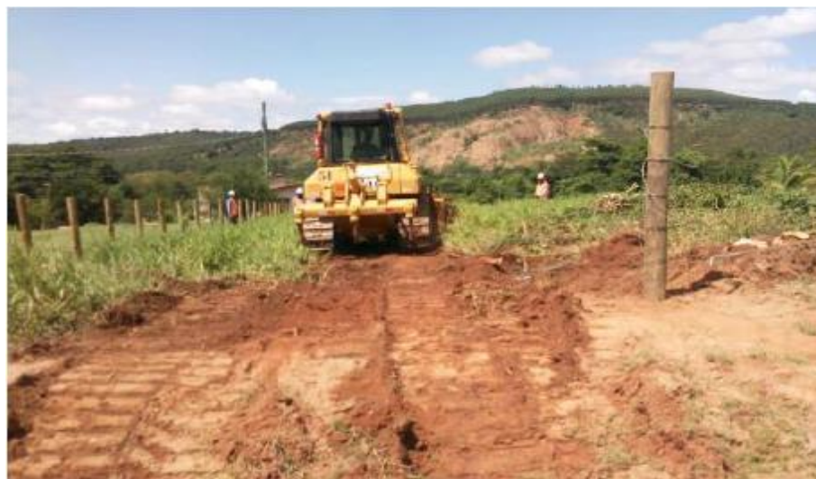
Foto relacionada à: limpeza de vegetação na área da captação no rio Corrente Grande em Governador Valadares/MG – janeiro/2020.
