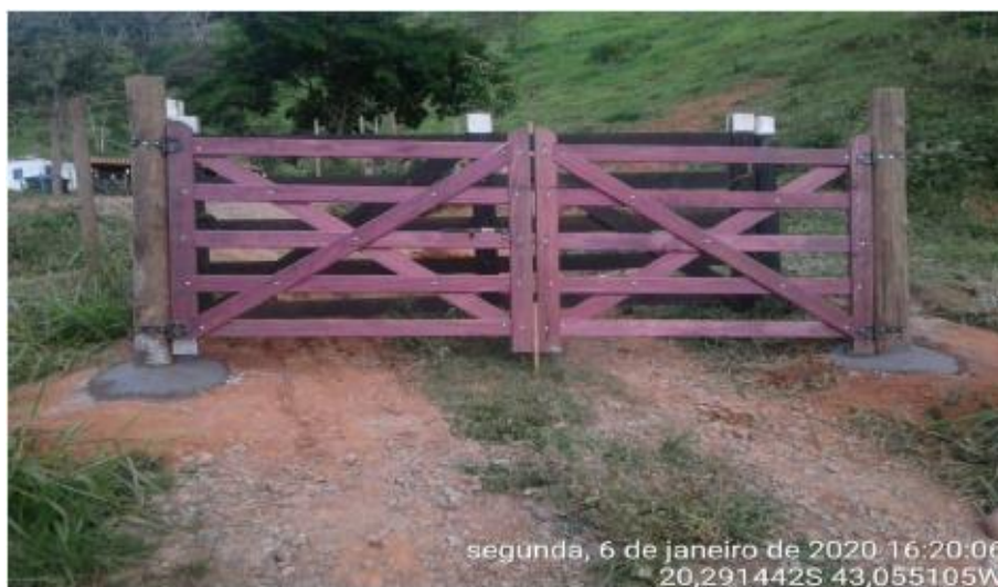
Foto relacionada à: Construção de infraestruturas rurais simples (porteiros) na propriedade E077 – Darci Humberto de Castro em Barra Longa/MG – janeiro/2020.
