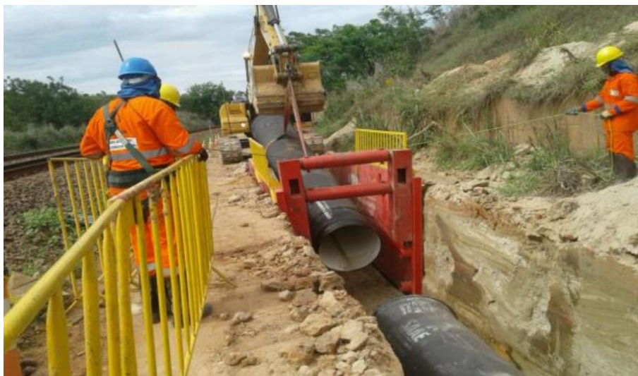
Foto relacionada ao: lançamento da tubulação no trecho ferroviário da adutora do rio Corrente Grande, em Governador Valadares/MG – novembro/2019.
