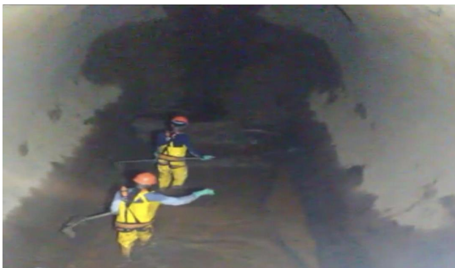
Foto relacionada à: Limpeza do conduto forçado da unidade geradora – UG3 – novembro/2019.
