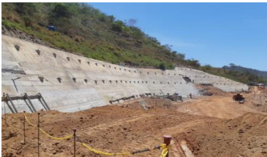
Foto relacionada à: Cortina atirantada no ponto 115 – novembro/2019.
