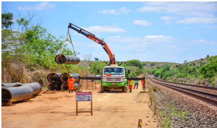
Foto relacionada ao: lançamento da tubulação no trecho da captação da adutora de Governador Valadares/MG – novembro/2019.
