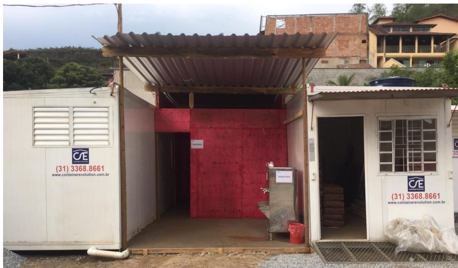
Foto relacionada à: Início das obras de reforma e ampliação do CAPSIJ, no município de Mariana/MG – Novembro/2019.
