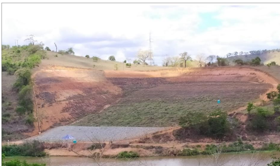
Foto relacionada ao: Retaludamento da crista do talude e abertura de drenagem no Setor 8 - novembro/2019.
