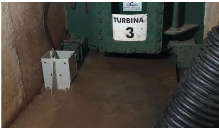
Foto relacionada à: Drenagem da unidade geradora – UG3- novembro/2019.
