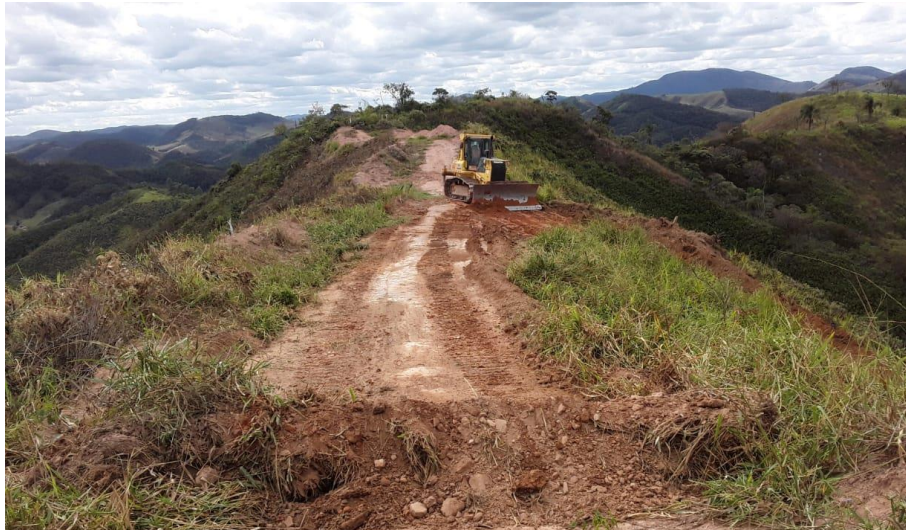
Foto relacionada à: Limpeza de top soil trincheira – Trecho A – Acesso Principal – julho/2019.
