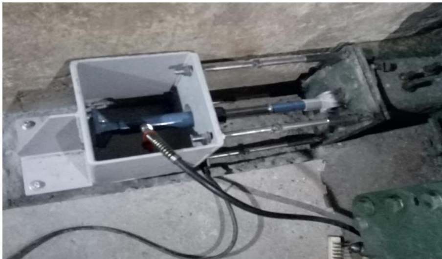
Foto relacionada ao: Dispositivo para drenagem instalado na UG03 - Julho/19.
