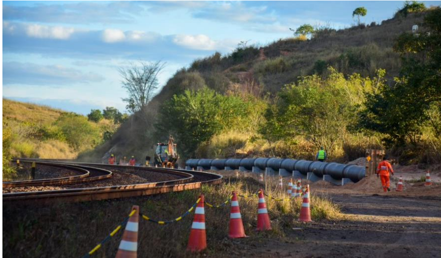
Foto relacionada ao: lançamento da tubulação no trecho ferroviário da adutora de Governador Valadares/MG – Julho/2019.
