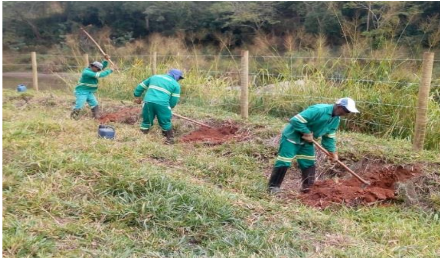
Foto relacionada à: Preparo de solo e espaçamento manual, TRECHO E - João Tavares - jul/2019. Barra Longa – MG.
