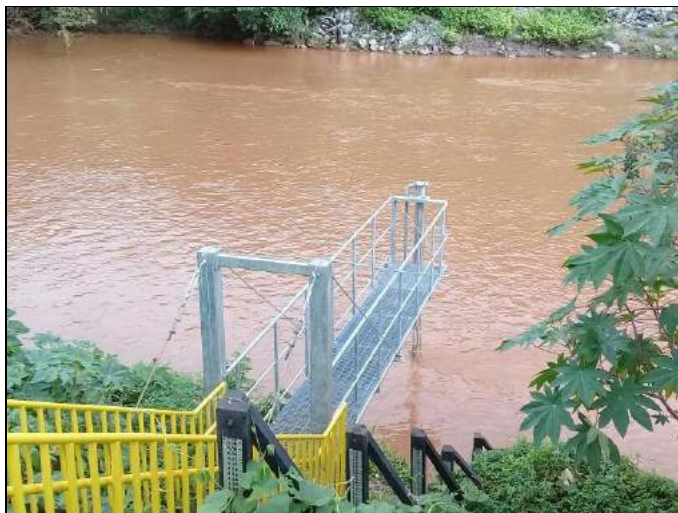
Figura 5-12 - Estação automática instalada nas margens do rio do Carmo (RCA 02).
