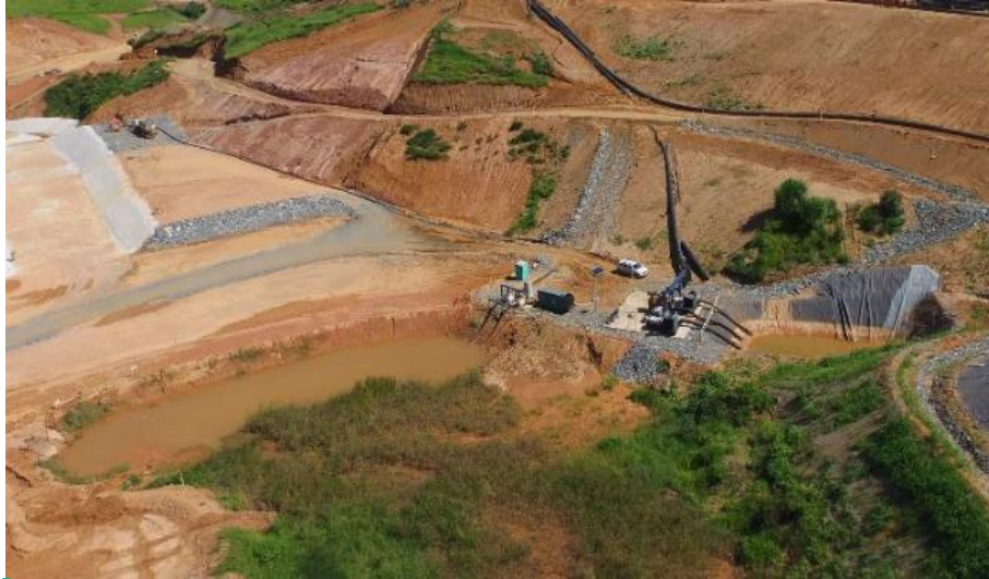
Foto relacionada à: Sistema de bombeamento Setor - 11 - Junho/19.
