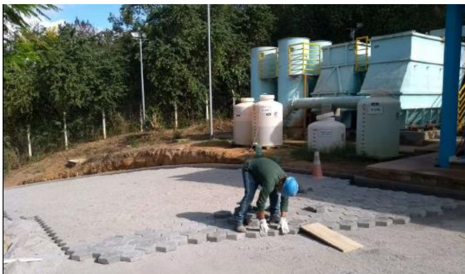
Foto relacionada à: pavimentação do acesso da ETA Recanto dos Sonhos/MG – Junho/2019.
