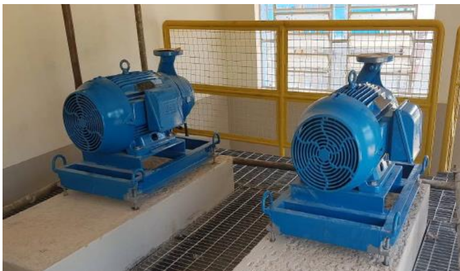
Foto relacionada à: montagem da motobomba da estação elevatório de água tratada da ETA de Galiléia/MG – Junho/2019.
