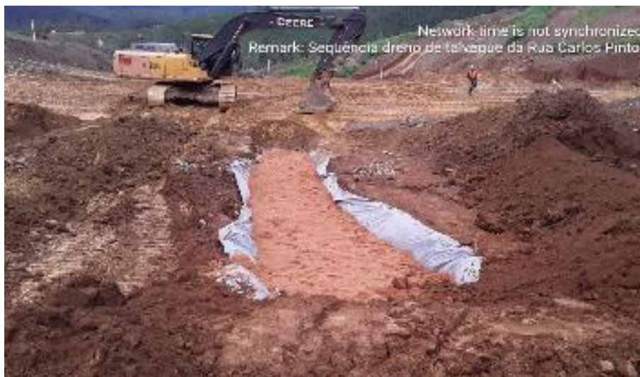
Foto relacionada à: Sequência das atividades do dreno talvegue da Rua Carlos Pinto – junho/2019.
