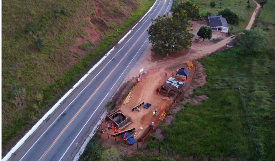
Foto relacionada ao: início das obras do Tunnel Liner da adutora de Governador Valadares/MG – Maio/2019.
