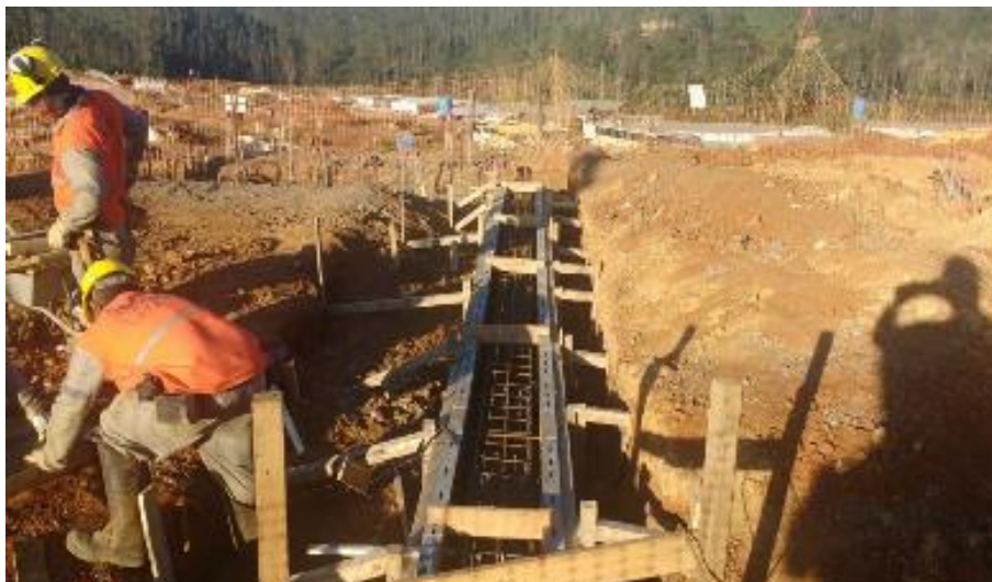
Foto relacionada à: Escola – Montagem de Forma de Viga de Coroamento – maio/2019.
