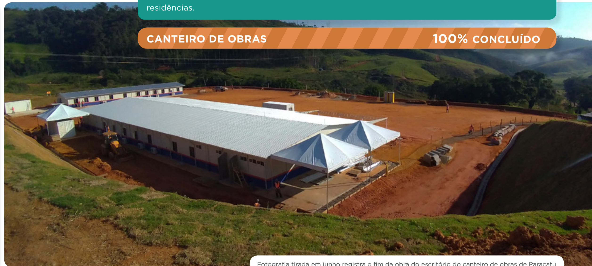
Fotografia tirada em junho registra o fim da obra do escritório do canteiro de obras de Paracatu
