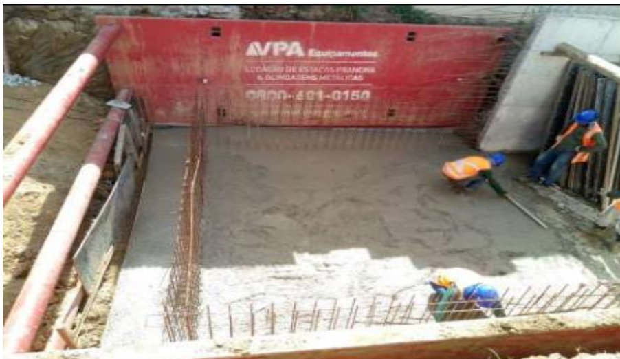
Foto relacionada à: Concretagem do piso das elevatórias da ETA de Galileia/MG – abril/2019.
