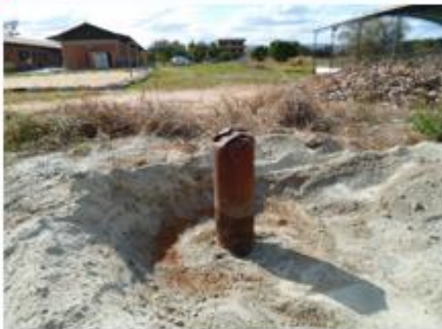
Tamponamento de poço tubular realizado em Santo Antônio do Rio Doce (Mauá), município de Aimorés/MG
