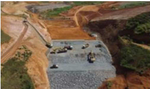
Dique principal – aterros em argila e enrocamento – agosto/2018 (Crédito: Divulgação Fundação Renova)
