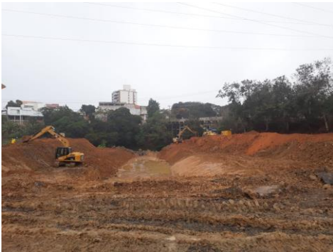
Início das obras para alargamento do canal em Rio Pequeno/ES – agosto/2018 (Crédito: Divulgação Fundação Renova)
