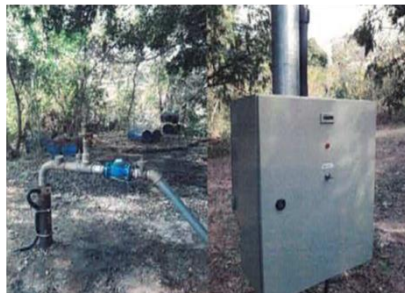
Instalação do hidrômetro e quadro de comando em Itueta - Sede
