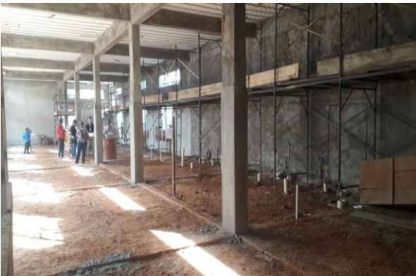
1º visita da comunidade às obras da nova sede da Escola de Paracatu de Baixo –junho/2018 (Crédito: Fundação Renova)
