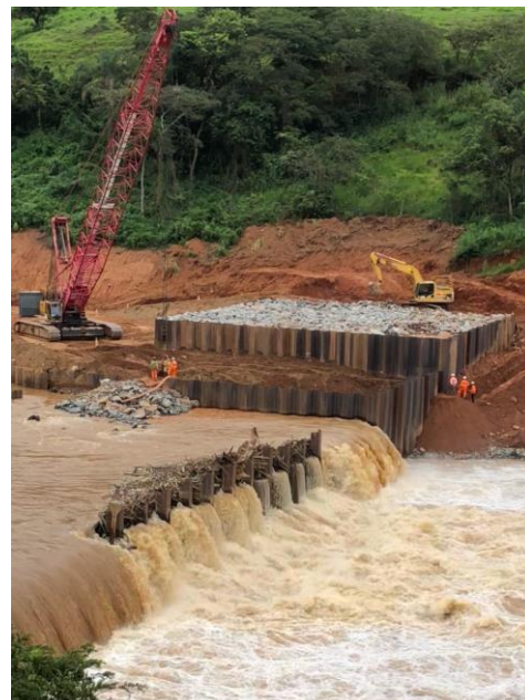
Barramento C - Conclusão da cravação das estacas prancha -março/2018 (Crédito: Divulgação Fundação Renova)
