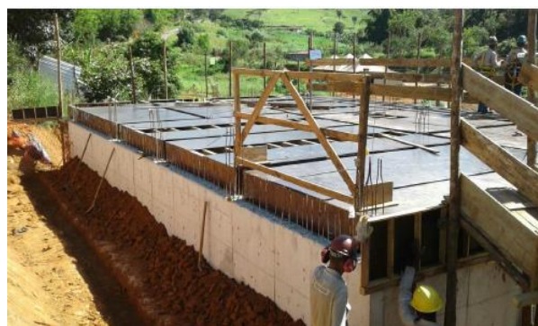
Reconstrução de propriedade rural em Mariana (Sr. Arlindo) – março/2018 (Crédito: Divulgação Fundação Renova)
