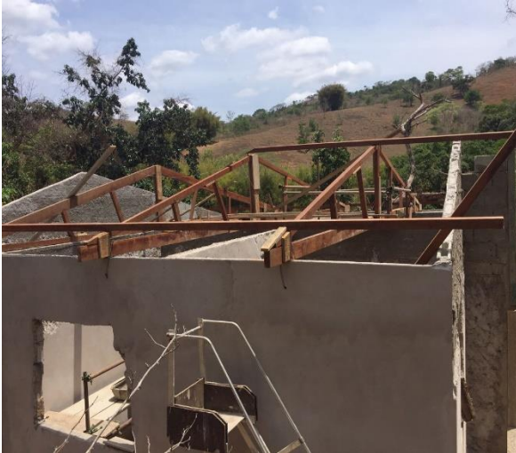
Instalação de estrutura de telhado, em Mariana (MG) – outubro/2017 (Crédito: Divulgação Fundação Renova)
