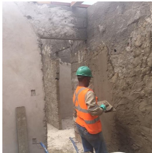
Reboco na propriedade do Sr. Pedro, em Mariana (MG) – outubro/2017 (Crédito: Divulgação Fundação Renova)
