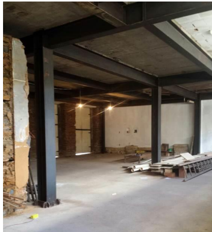
Espaço Interno do Centro de Informação e Atendimento em Mariana (MG) – agosto/2017 (Crédito: Divulgação Fundação Renova)
