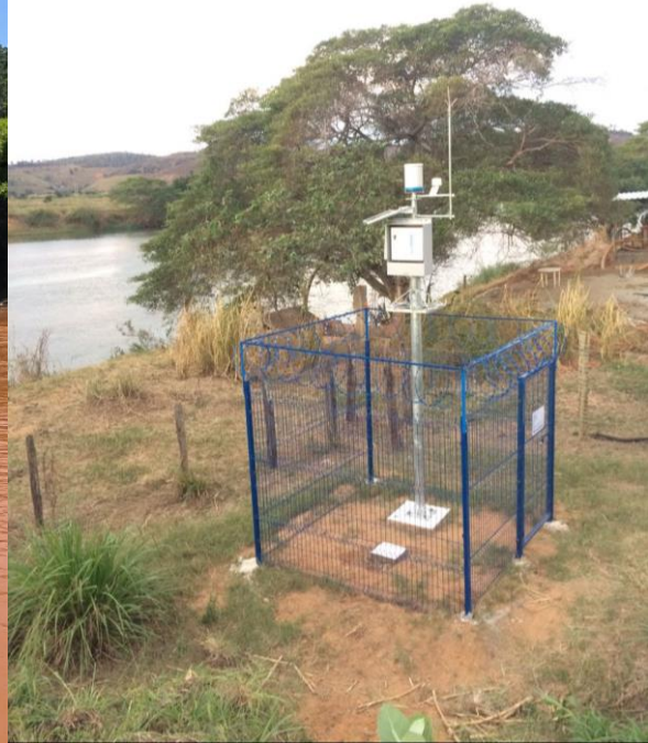
Estação automática do Tipo I instalada no rio Manhuaçu em Aimorés/MG (código RMH01) – julho 2017 (Divulgação:
