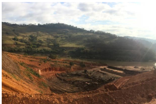
Retrabalho no material de Bota fora jazida Setor 8 – julho/2017 (Crédito: Divulgação Fundação Renova)
