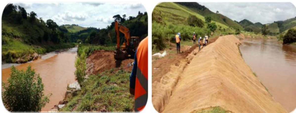
Figura 69 - Reconformação de calha de rio – Área 9 (esquerda), atividades de bioengenharia e reconformação de calha – Área B (direita).
