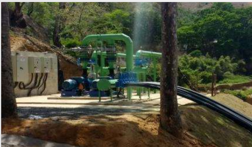
Sistema de Bombeamento e Boosters
