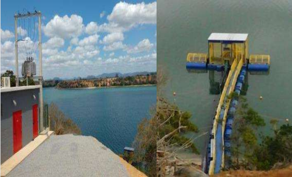
Sistema de Bombeamento e Subestação
