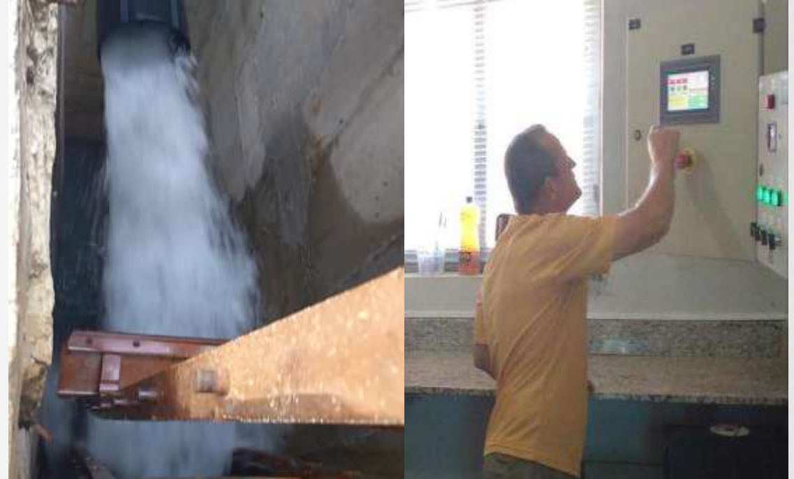
Chegada de água no SAAE e painel de operação Remota
