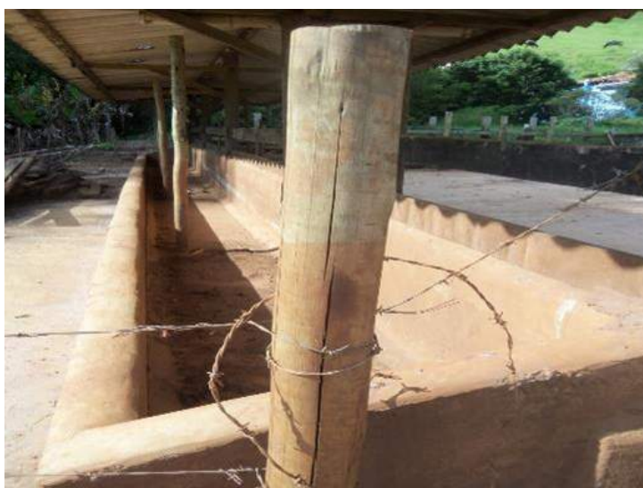
Figura 118 Cocho de concreto
