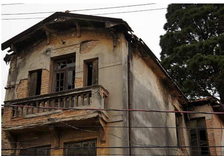
Figura 74 Cosas com estado de conservação de reparos importantes
