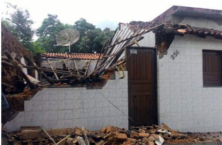
Figura 75 Cosas com estado de conservação de reparos importantes à edificação sem valor
