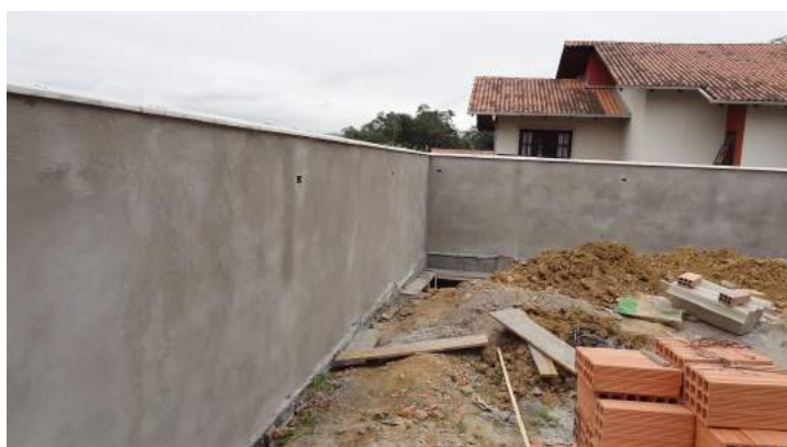
Figura 87 Muro com reboco
