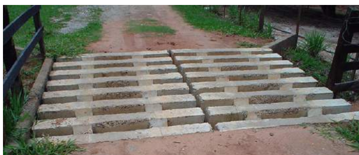
Figura 120 Mata burro de concreto
