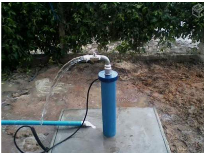
Figura 99 Poço semi artesiano
