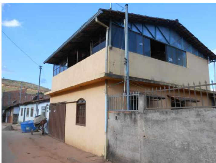
Figura 70 Cosas com estado de conservação regular
